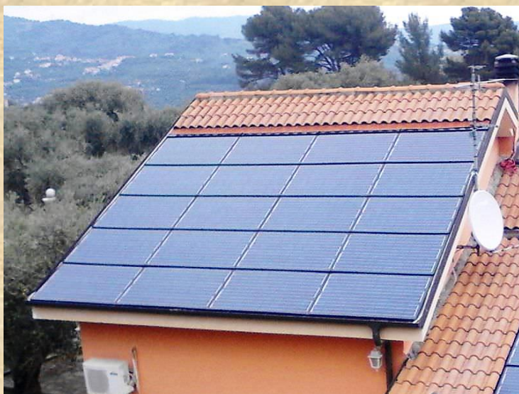
Tetto con impianto fotovoltaico
